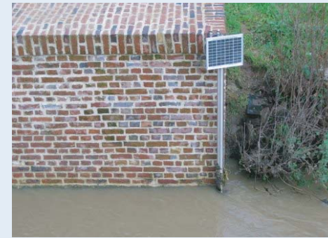
Station d'Aire sur la Lys (installée en Décembre 2006)
